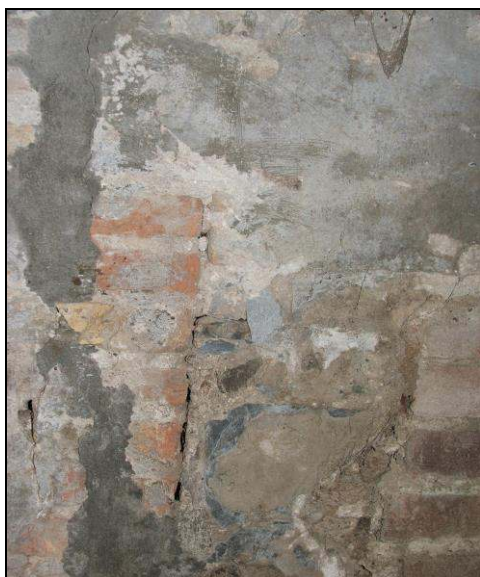
Ruimte -1.1 bij voorgevel verticale naad met haaks omlopend metselwerk
